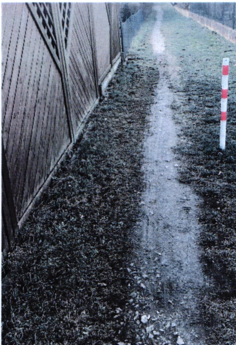
Zustand des Weges im Bereich der Straße Eickenpfahl zur Benninghauser Straße hin
