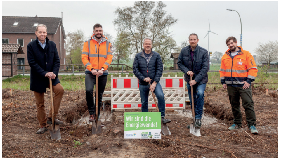
Spatenstich in Diestedde, v.l.: Hendrik Keitlinghaus, Alexander Magel (Leiter Infrastruktur WLE), Ludger Rembeck, Dr. Torsten Winkelkemper (beide UEW) und Timo Krilleke (Teamleiter Bautechnik WLE).
